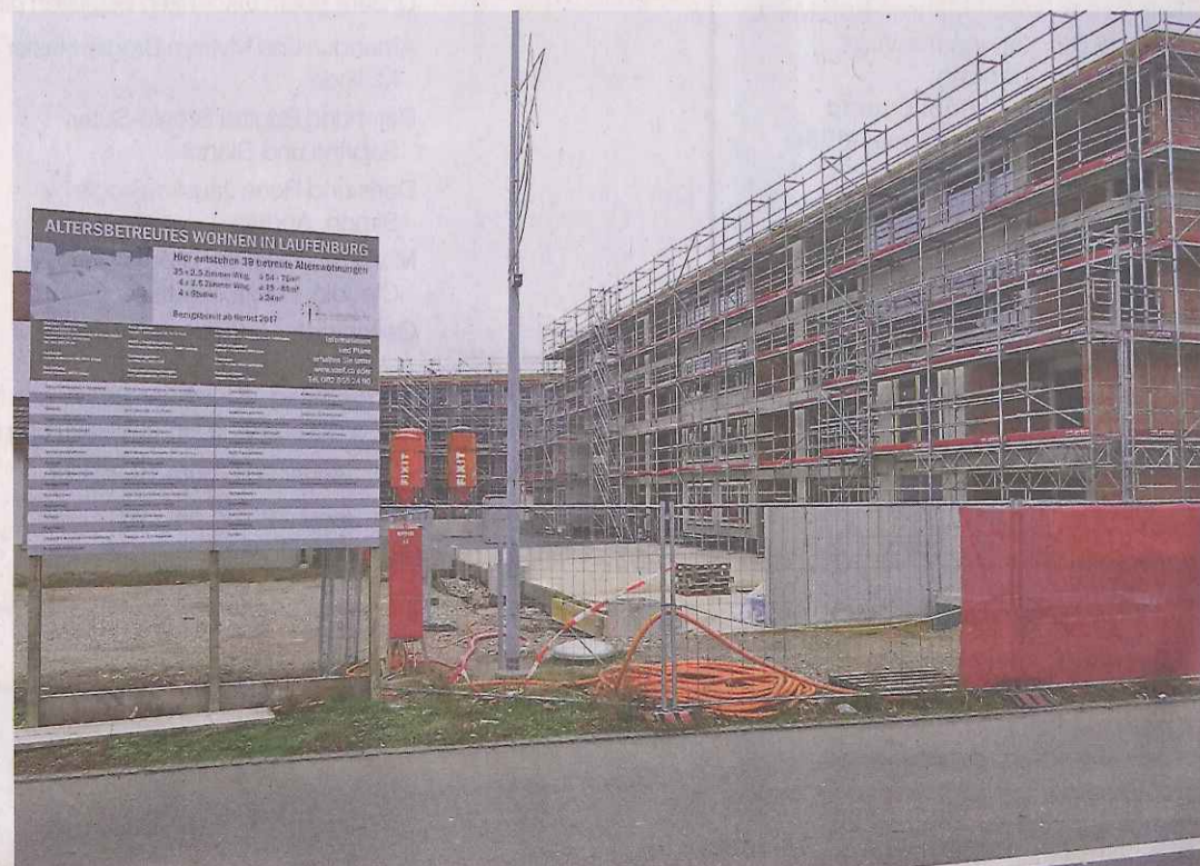
In Laufenburg entsteht beim Bahnhof zurzeit eine grosse Überbauung mit betreuten Alterswohnungen.
